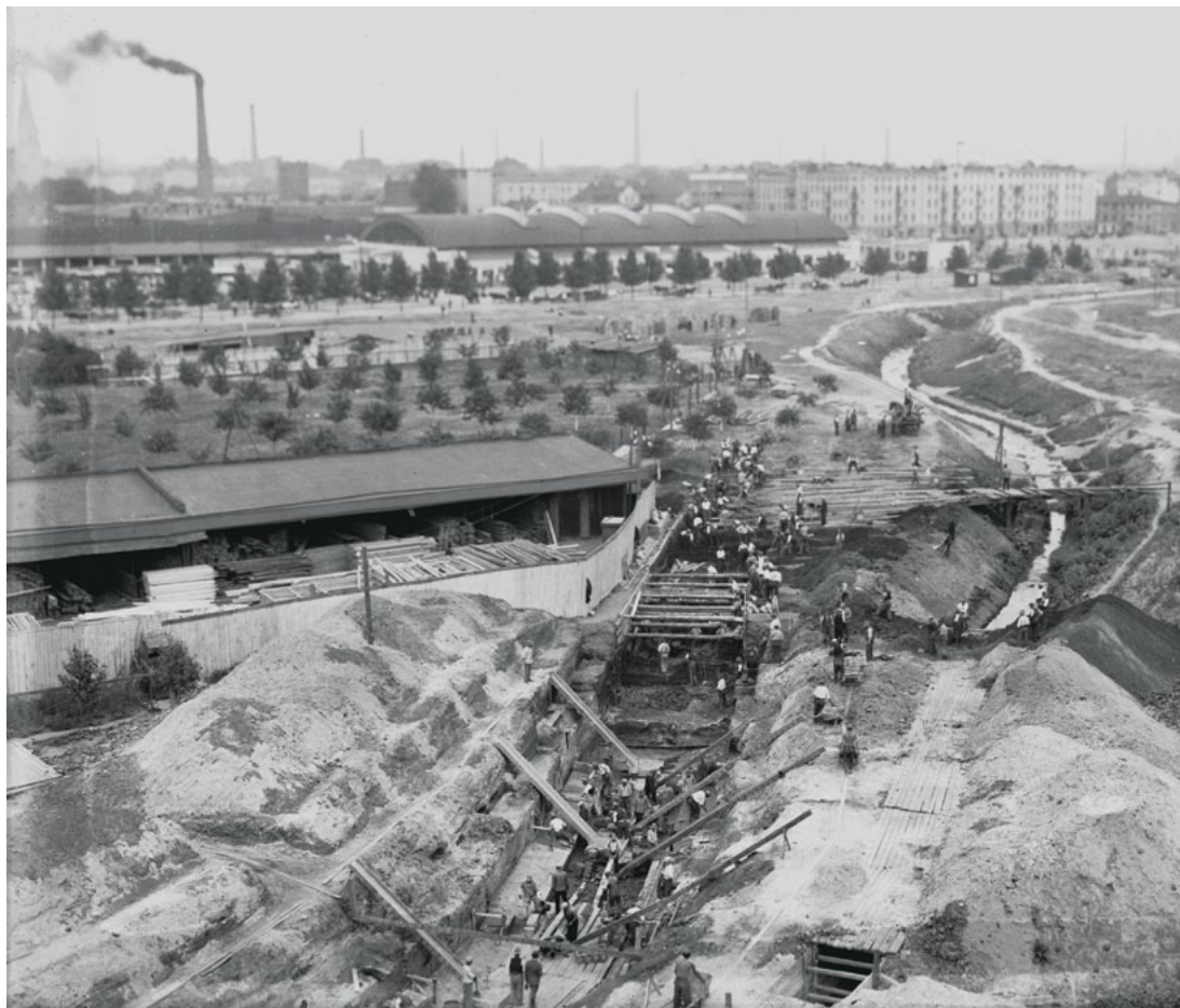
Budowa kanalizacji w pobliżu Górnego Rynku, ok. II poł. lat 30. XX w.
